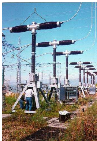
FIGURA 2: Interruptores de potencia tipo FL245.
